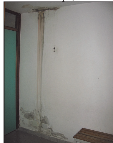
Le infiltrazioni d'acqua
