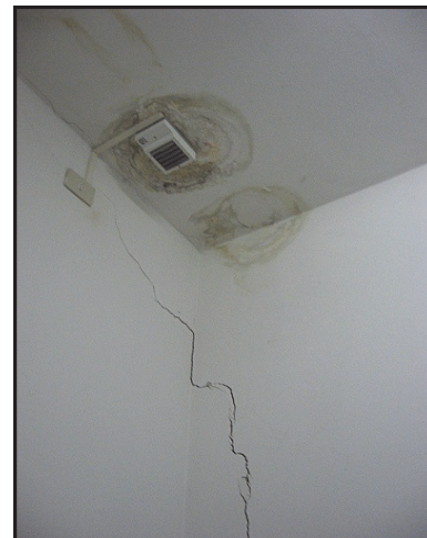
Le infiltrazioni d'acqua e le crepe
